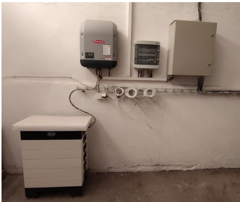
Fotovoltická elektráreň 8,5 kW Baterkový systém na uskladnenie elektrickej energie
